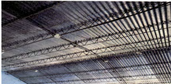
Foto 10: Lamina en mal estado por corrosión.
