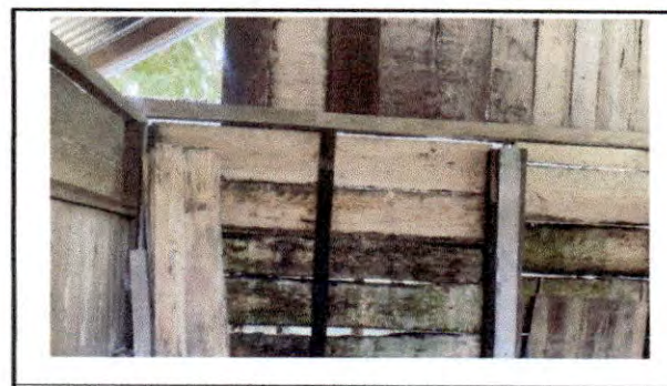
Foto 6: Estructura de madera en mal estado.
