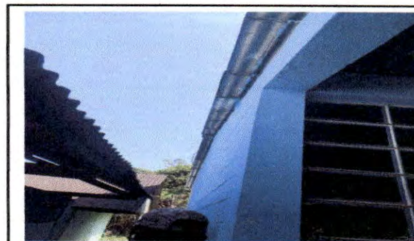
Foto 4: Techo de lamina en mal estado.
