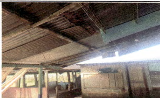
Foto 11: Láminas en estado ineficiente.
