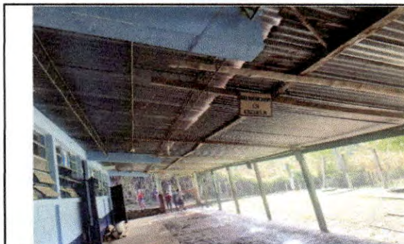
Foto 3: Estructura de madera corroida.
